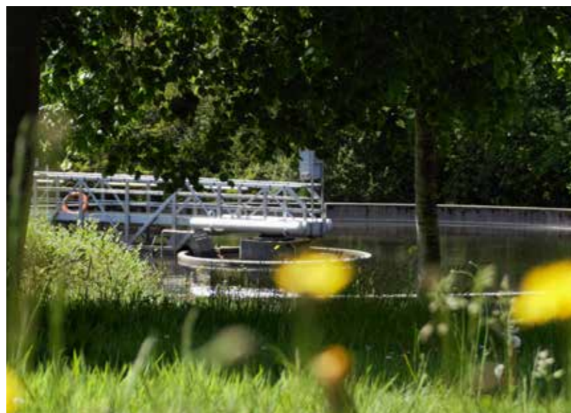
Clarificateur STEU Lisieux
