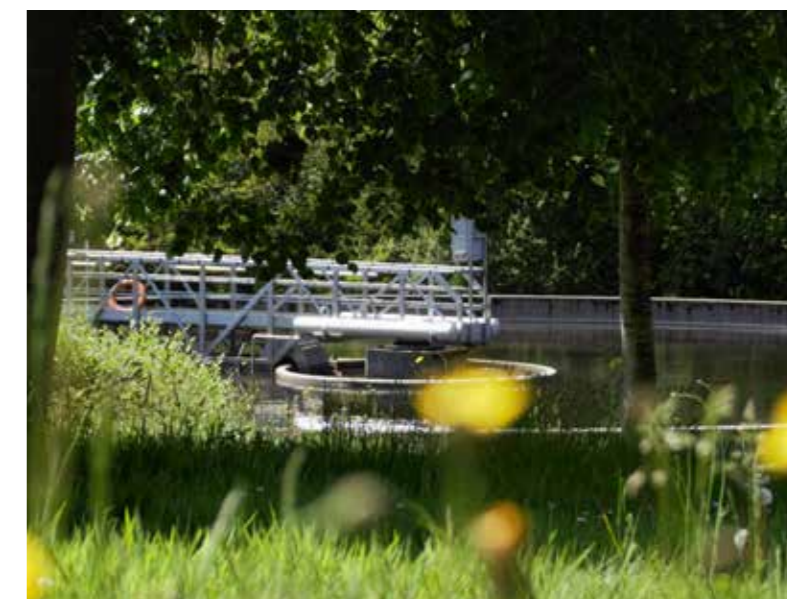
Clarificateur Station de Traitement des Eaux Usées (STEU), Lisieux
