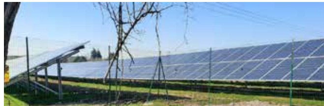
Parc photovoltaïque à Orbec
